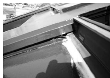
写真2 漏水の疑われる箇所
