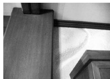
写真1 室内の漏水箇所
