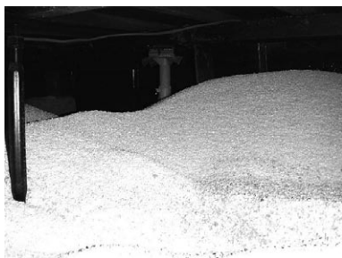
写真二 床下に大量に散布された乾燥剤？
