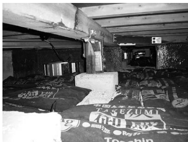
写真一 床下の無意味な補強工事
