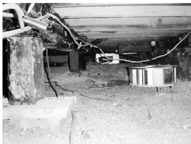
写真三 高額で不必要な床下換気扇
