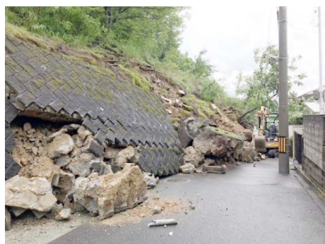
被災状況(豊能町光風台6丁目緑地)
